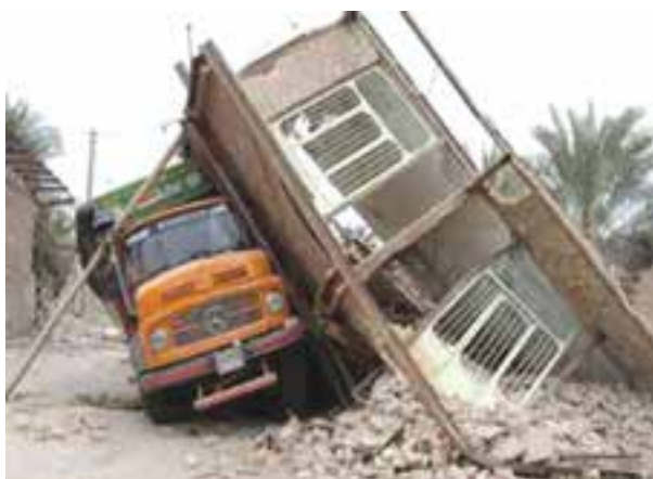
(د) ریزش دیوار در اثر زلزله
